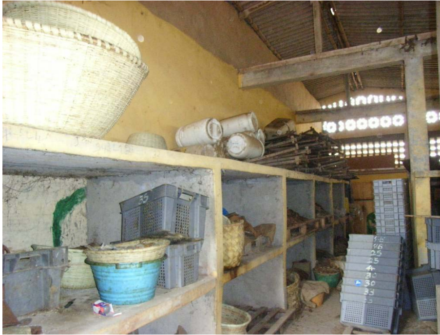
Stockage de poissons et de matériels dans un magasin : à éviter
